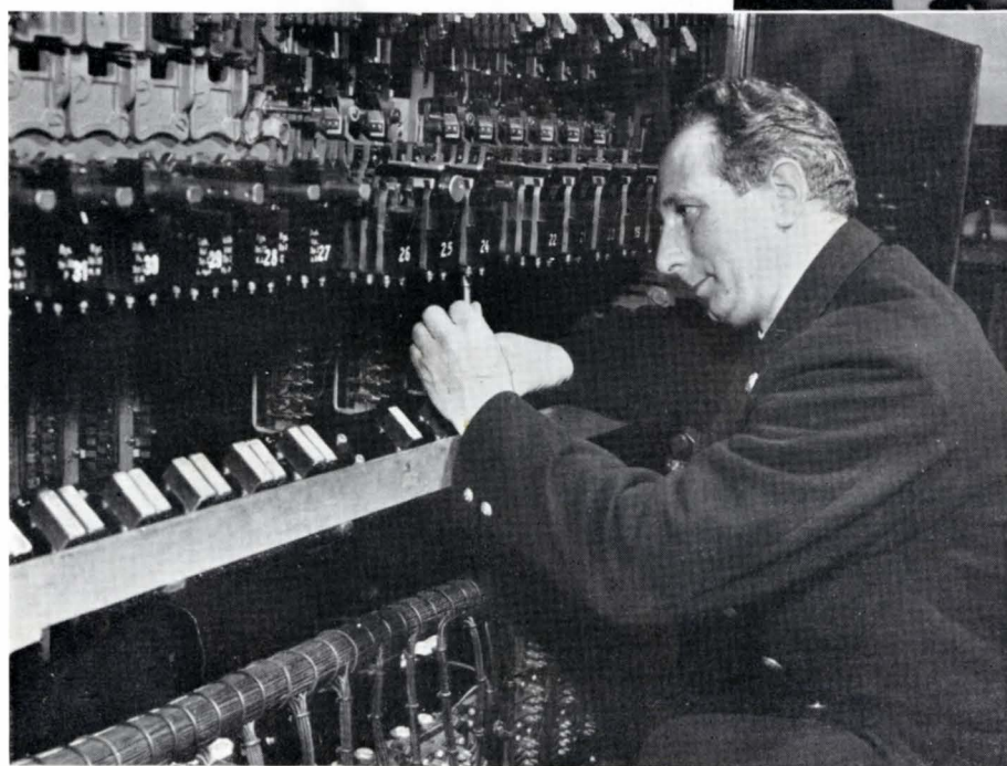
Eftersyn af et moderne elektromekanisk centralapparat.
