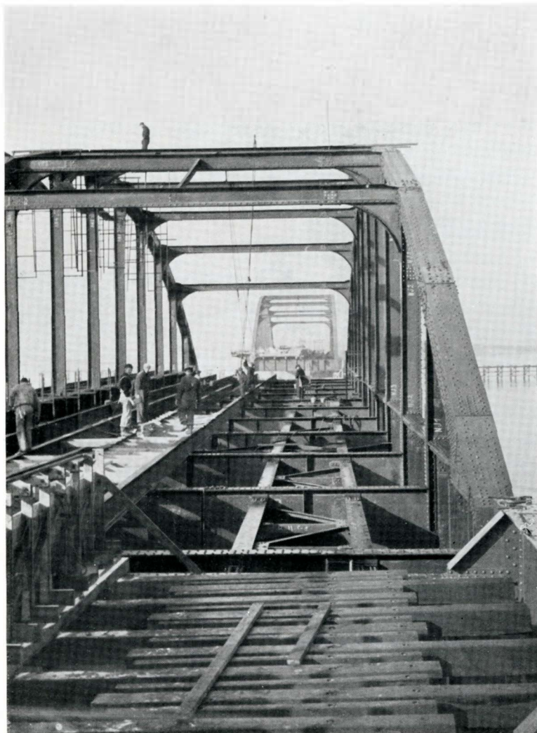
Et Buesjag er anbragt paa Pillerne. Opstilling af Forskalling til Støbning af Bæredæk er paabegyndt (i. v.). I Forgrunden ses Brotømmeret for Sporet
