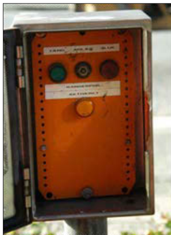
Betjeningskasse på stander på Casper Müllers Gade.
