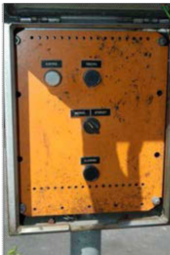
Betjeningskasse ved Nordkajen.
