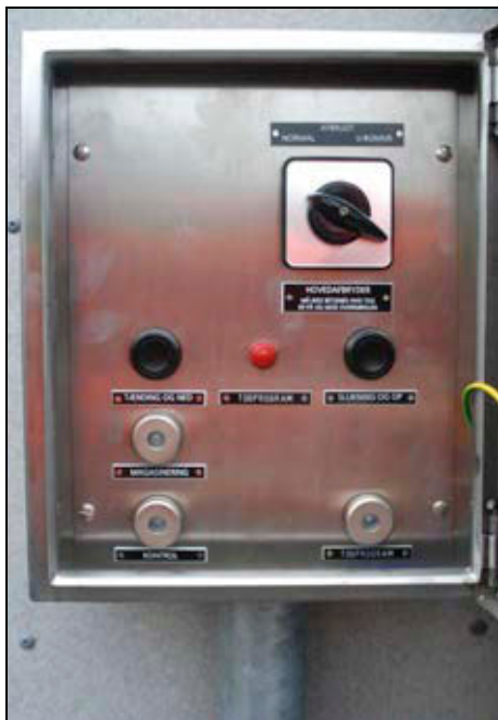
Betjeningskasse for overkørsel 0b nord for Sjællandsgade
