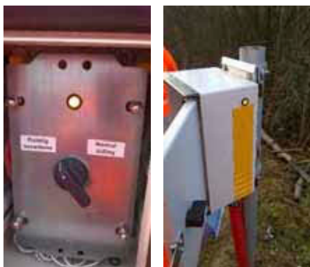
Stedlig dækning indkoblet
