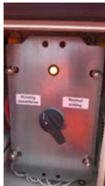
Stedlig dækning indkoblet:
