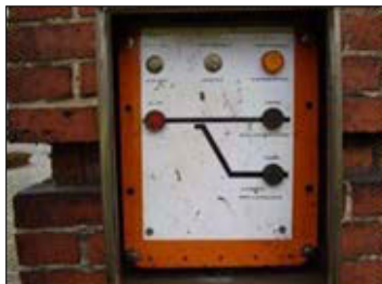
Betjeningskasse på husgavlen ved firmaet H. Daugaard.
