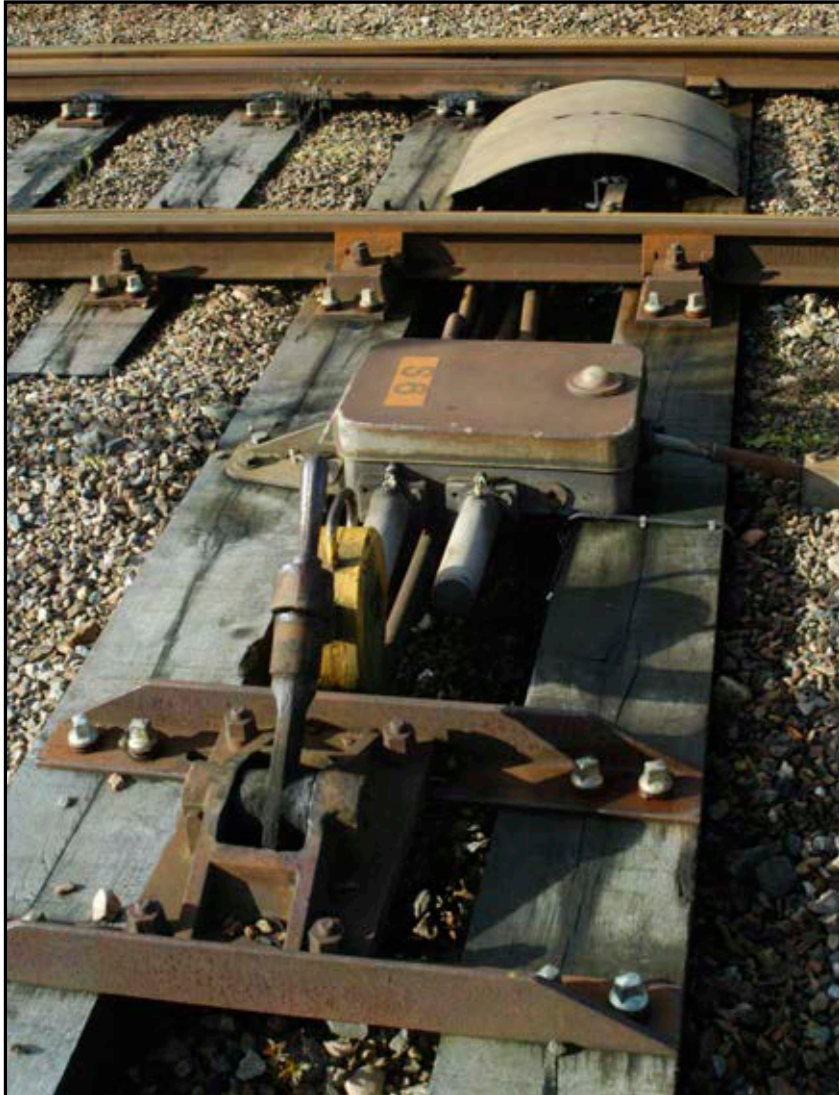
Centralaflåst sporskifte med magnetlås
